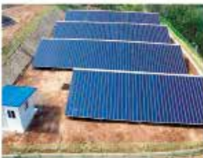
봉현태양광 발전소 30kw
