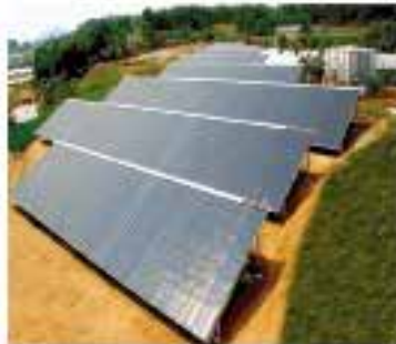
신동태양광 발전소 30kw
