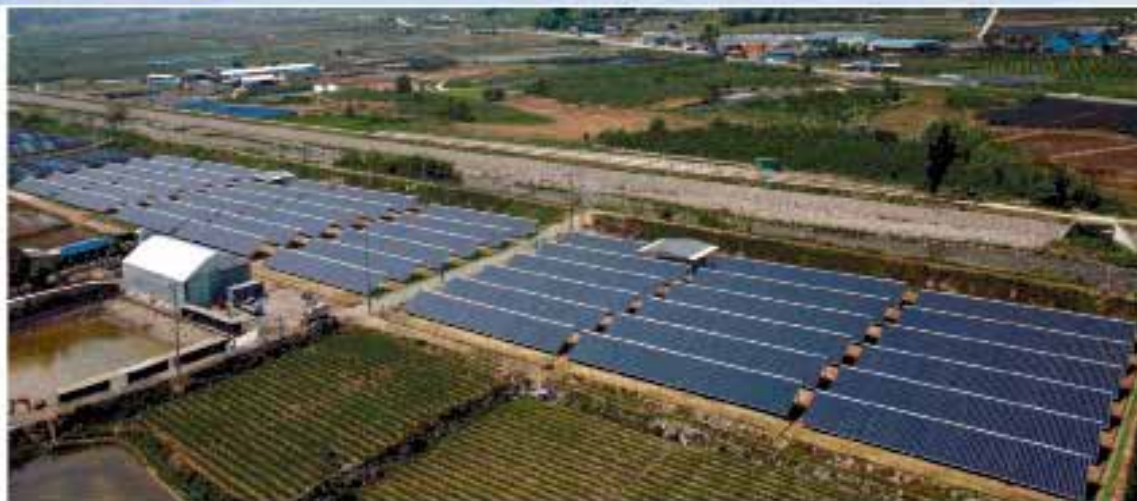
풍기 태양광 발전소 550kw
